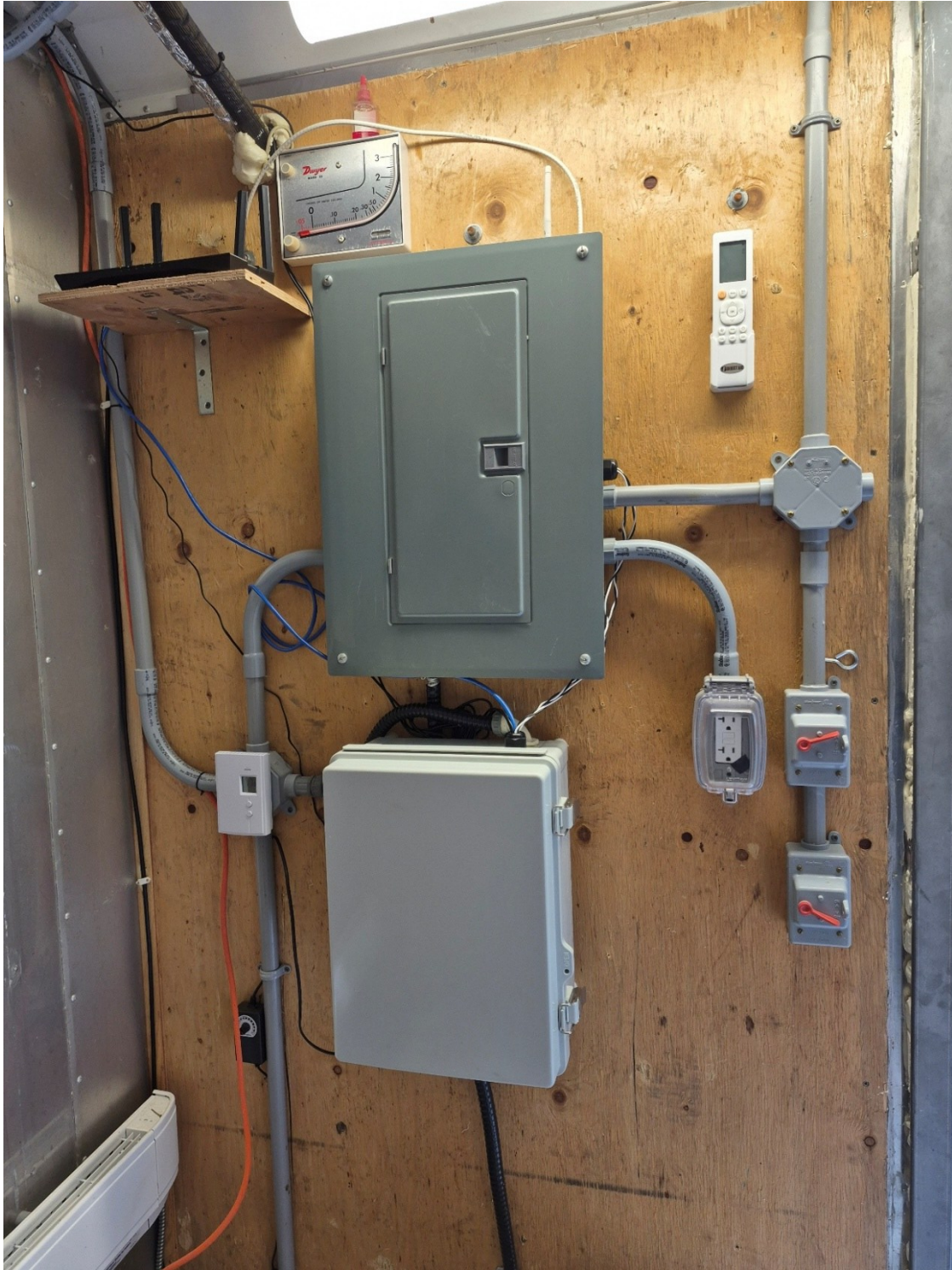
Figure 13 Section SAS disposant du panneau de l'entrée électrique 230V/100A, de la boîte contenant le contrôleur Ubibot, de la plinthe électrique pour chauffer cette section, son thermostat, le routeur, un variateur du ventilateur (100%), une télécommande pour thermopompe et le manomètre de la pression statique.
